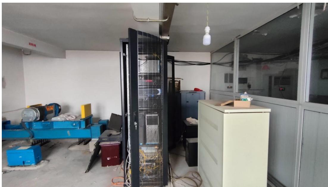
四号楼电梯机房
